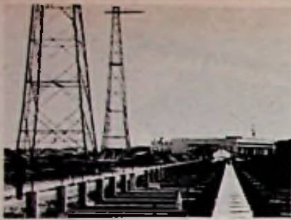
Afb. 3. Kabelstraat langs de in aanbouw zijnde noordarm. Op de achtergrond het antenne-kiescentrum. Links, in aanbouw, antennemasten.
